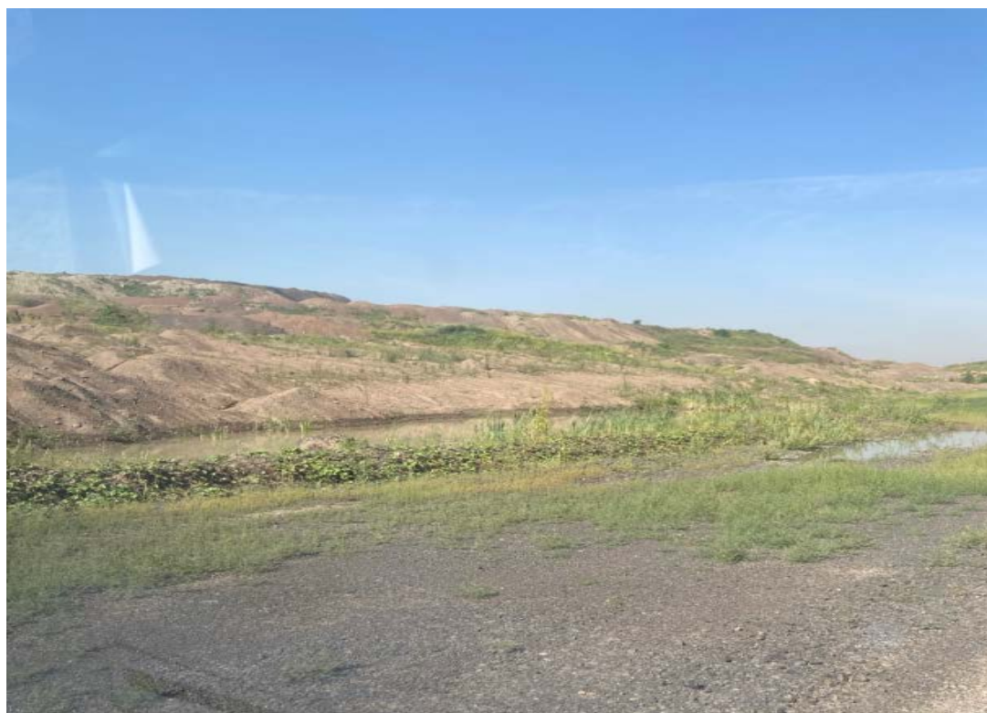
Рисунок 28 – Фиксация высачиваний воды в отвальном сооружении
